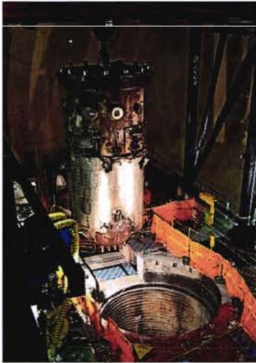
Foto 14. Big Rock Point-Michigan, USA: Verwijdering van het reactorvat in één stuk bij GKN' s zustercentrale.
